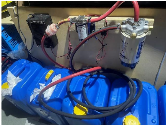
Het filtersysteem thuis
