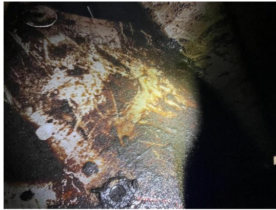
De vervuiling onderin de tank.
